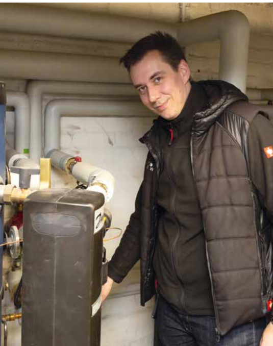
Hauswart Sven Röseler überprüft in einer Heizzentrale die Verbrauchswerte an einem Wärmemengenzähler.
